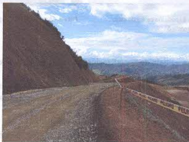
Foto 6.- Vía a canales construida sin monitoreo.
