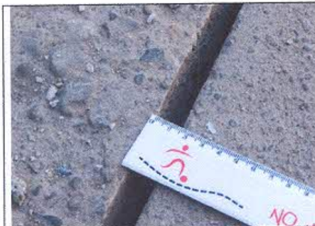
Fotografía nro. 1: Tamaño de grieta en vía de acceso a Escuela La Inmaculada. Fuente: INPC R7
